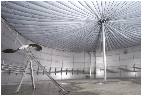
Εικόνα 6.3. Εσωτερικό κατακόρυφου χωνευτήρα με σύστημα θέρμανσης και ανάδευσης
