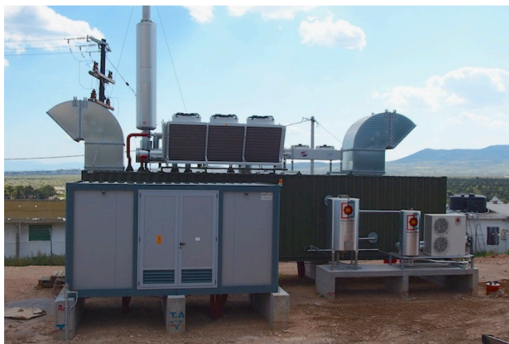
Εικόνα 1.3.1. Μονάδα συμπαραγωγής ηλεκτρικής και θερμικής ενέργειας
