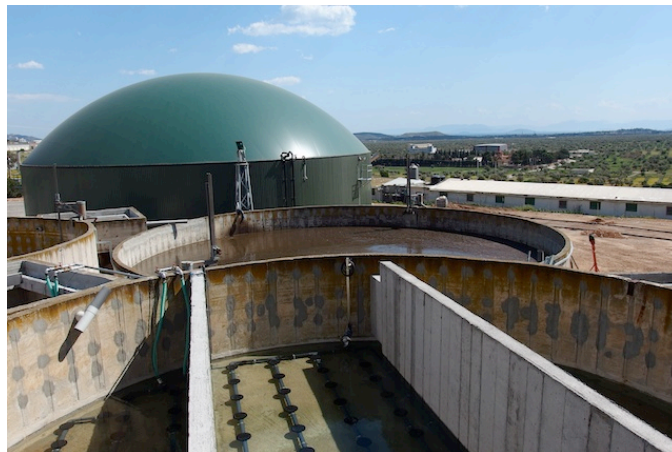
Εικόνα 1.6.1. Δεξαμενή αερόβιας επεξεργασίας αποβλήτων και νιτροποίησης – απονιτροποίησης
