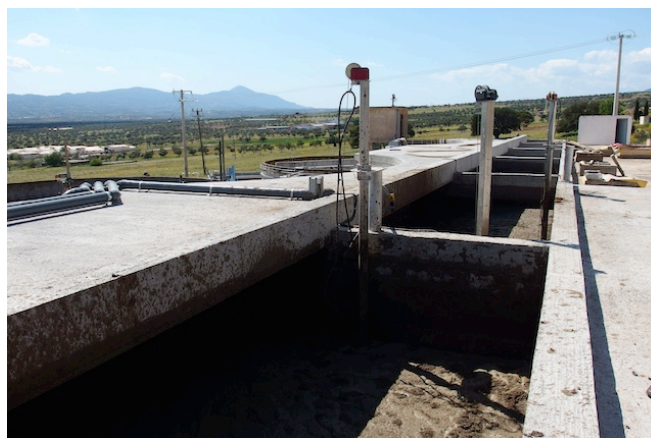
Εικόνα 1.1.1. Δεξαμενές προετοιμασίας υγρών αποβλήτων
