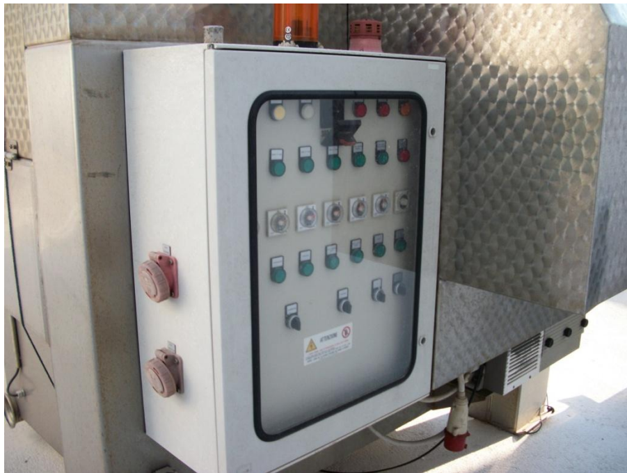
Velo 6.5- Πίνακας Ελέγχου
