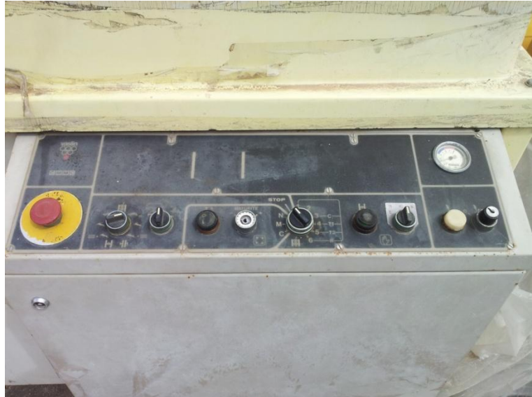
Πίνακας χειριστηρίου vaslin cep 420
