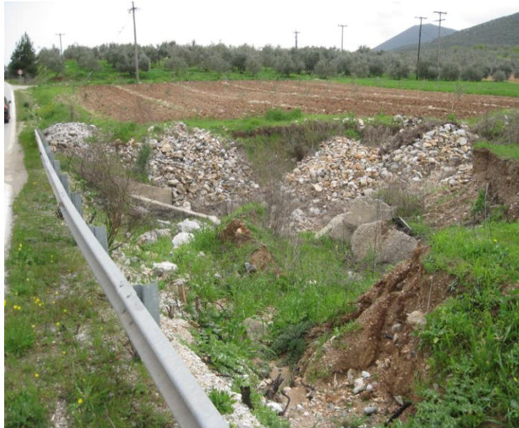
Εικόνα XIV.1: Επιχωμάτωση ρεύματος με κροκάλες, στη θέση «Κάραβος» Σούρπης, (Αρχείο Χουλιάρης Γ., 2013)
