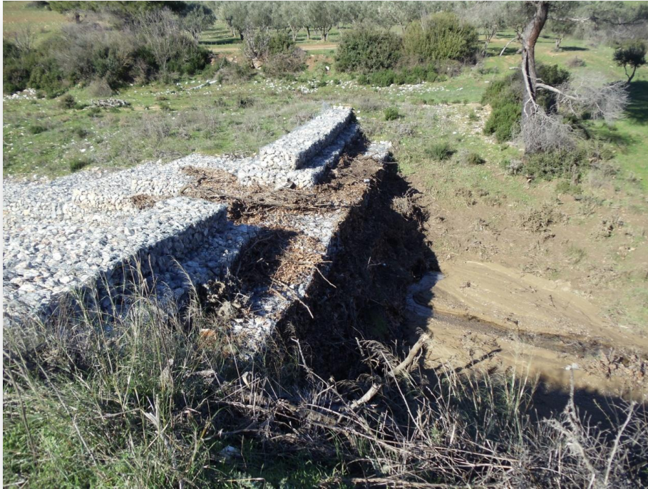
Σχήμα 16: Το φράγμα του Σπαρτορέματος, αποτελείται από διατεταγμένα εγκάρσια στην κοίτη συρματοκιβώτια, κατάλληλα να συγκρατούν μεγάλο ποσοστό ιζήματος. (φωτ. 4.1.2013).
