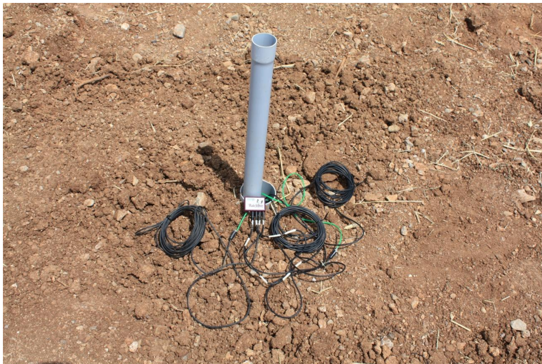
Εικόνα 11: Ολοκλήρωση εγκατάστασης αισθητήρων εδαφικής υγρασίας και θερμοκρασίας, σύνδεση με καταγραφικό δεδομένων και έναρξη μετρήσεων.
