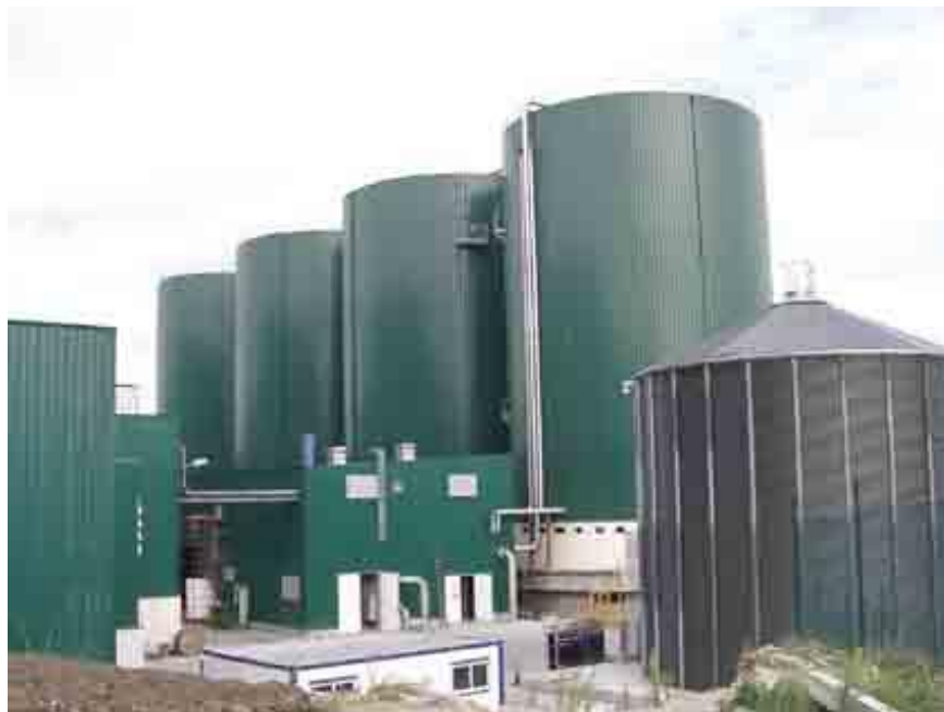
Εικόνα 3.5.1. Μονάδα Παραγωγής Βιοαερίου (Πηγή: Cleantech Solutions )
