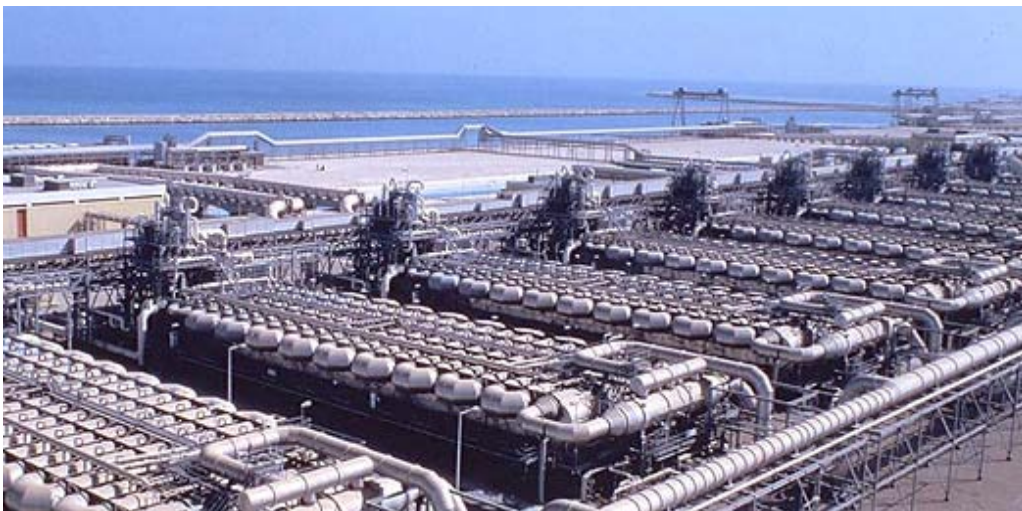
Εικόνα 2.1 Εγκατάσταση πολυβάθμιας εκτόνωσης στη Σ. Αραβία
