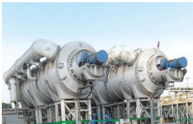
Εικόνα 2.3 Εγκατάσταση ανασυμπίεσης ατμών
