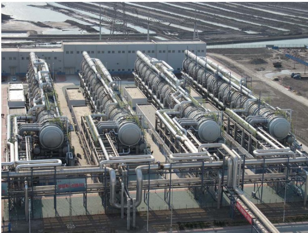
Εικόνα 2.2 Εγκατάσταση πολυβάθμιας εξάτμισης στα Η. Α. Εμράτα
