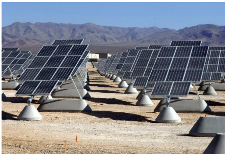
Εικόνα 3.3 Το πάρκο Nellis Solar Power Plant στην βάση Nellis Air Force Base στις ΗΠΑ. Αυτές οι διατάξεις ακολουθούν την πορεία του ηλίου σε έναν άξονα
