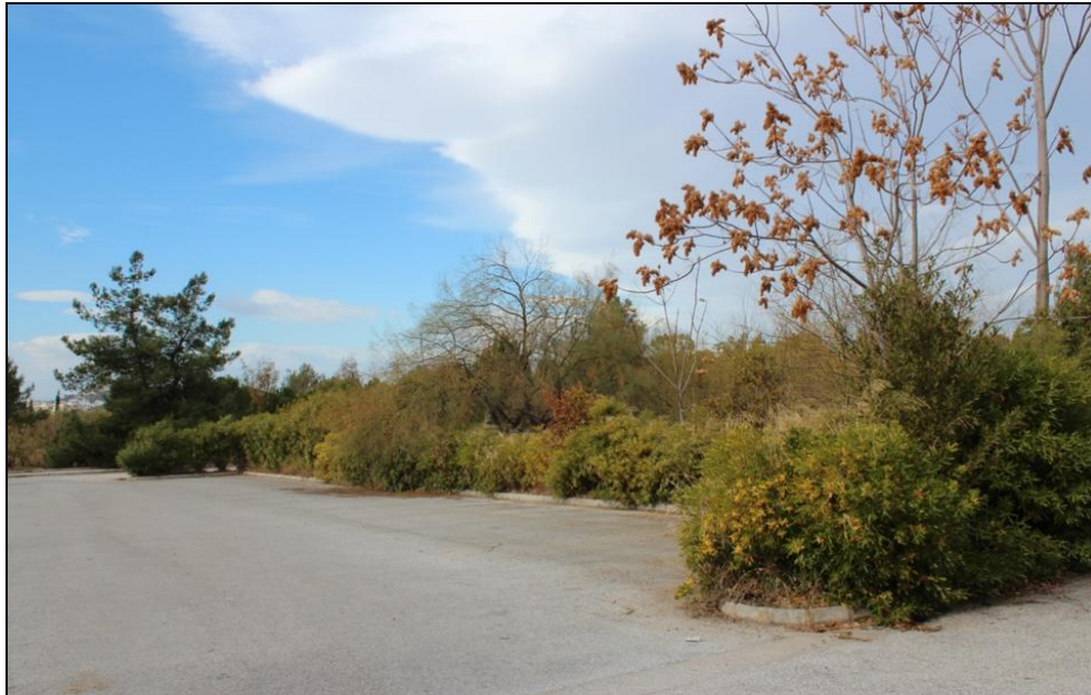
Εικ. 5.47 Χώρος στάθμευσης στο Θωμαεΐδιο. Μειωμένο επίπεδο συντήρησης φυτών και απουσία δέντρων με αποτέλεσμα την μη επαρκή σκίαση.
