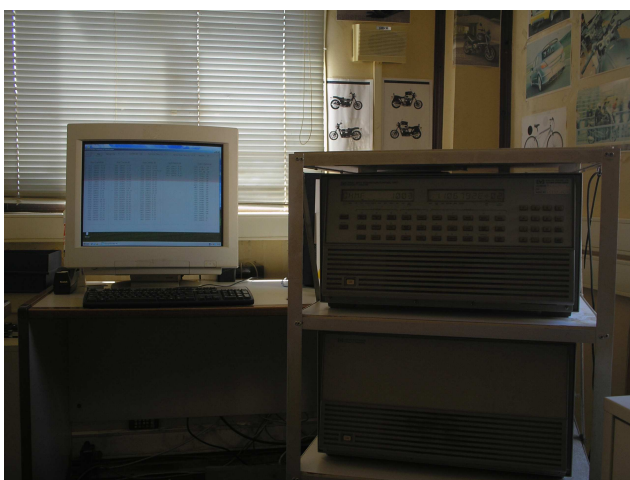
Εικόνα 7.10. Το καταγραφικό (HP-DAS 3852A) και παρακολούθηση των μετρήσεων και των εντολών ελέγχου μέσω λογισμικού interface στο PC.
