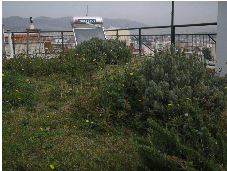
Εικόνα 1.8. Ημιεντατικού τύπου φυτοδώμα, σε πενταώροφη πολυκατοικία του '80, στο Ίλιον ( Αρχείο: Κοτσίρη Γ.).
