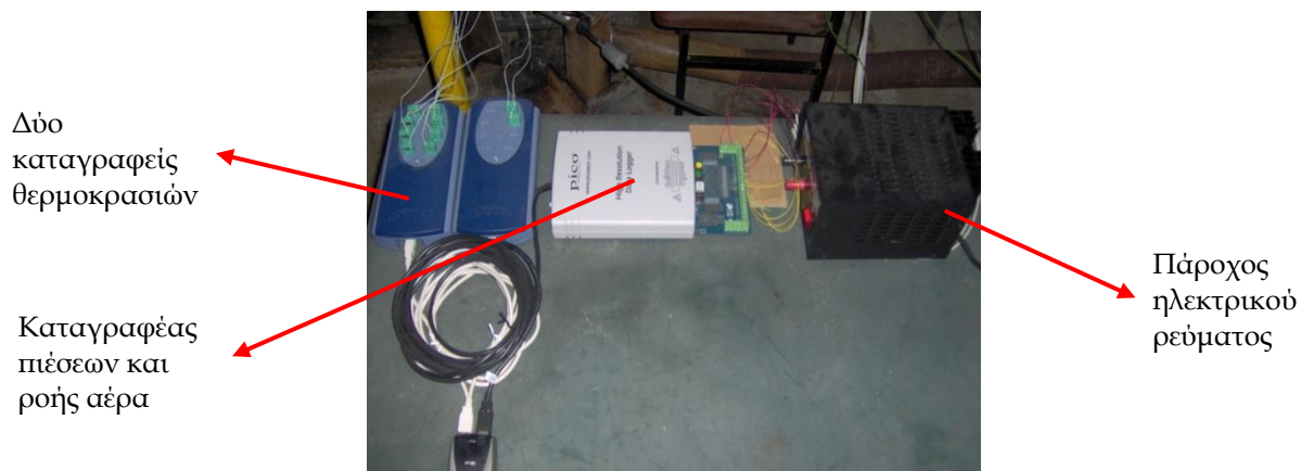
Εικόνα 4-22 Καταγραφείς Δεδομένων και πάροχος ηλεκτρικού ρεύματος 24V
