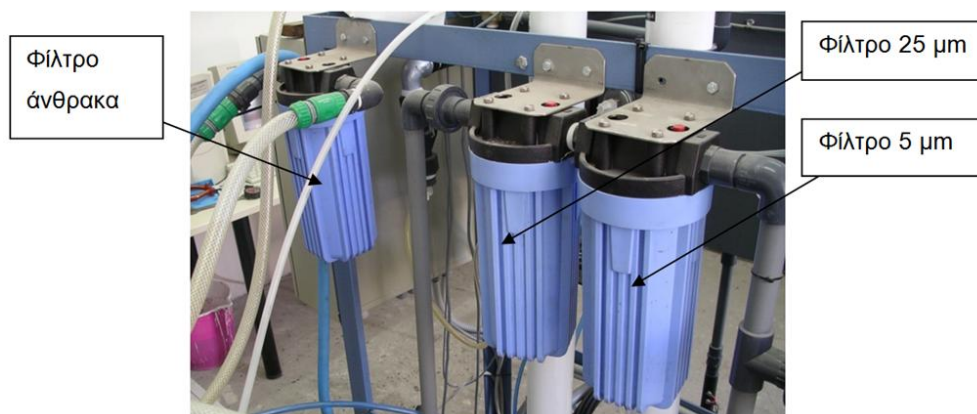
Εικόνα 3-8: Φίλτρα προεπεξεργασίας του νερού
