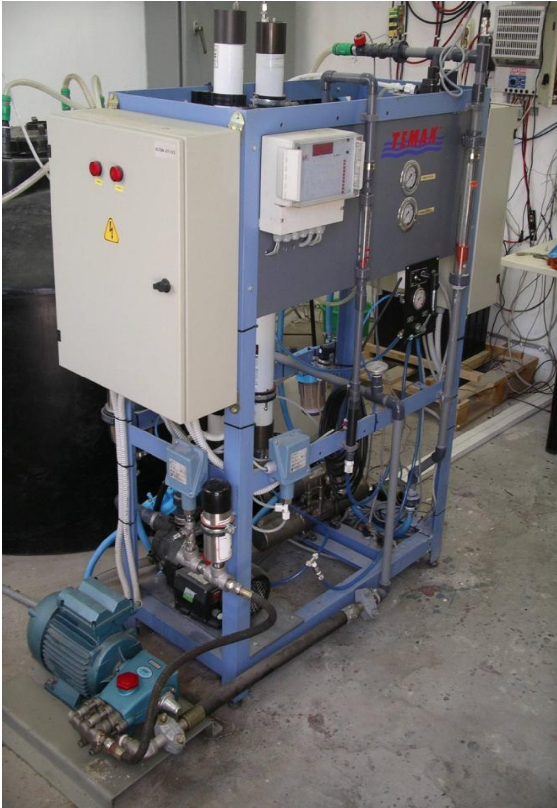
Εικόνα 3-14: Η μονάδα αφαλάτωσης αντίστροφης ώσμωσης
