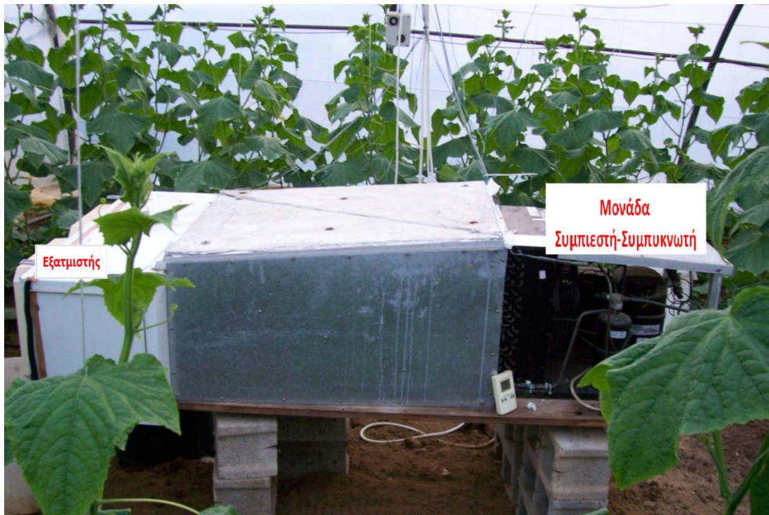
Εικόνα 3.4. Άποψη της αντλίας θερμότητας που χρησιμοποιήθηκε για την αφύγρανση του θερμοκηπίου.
