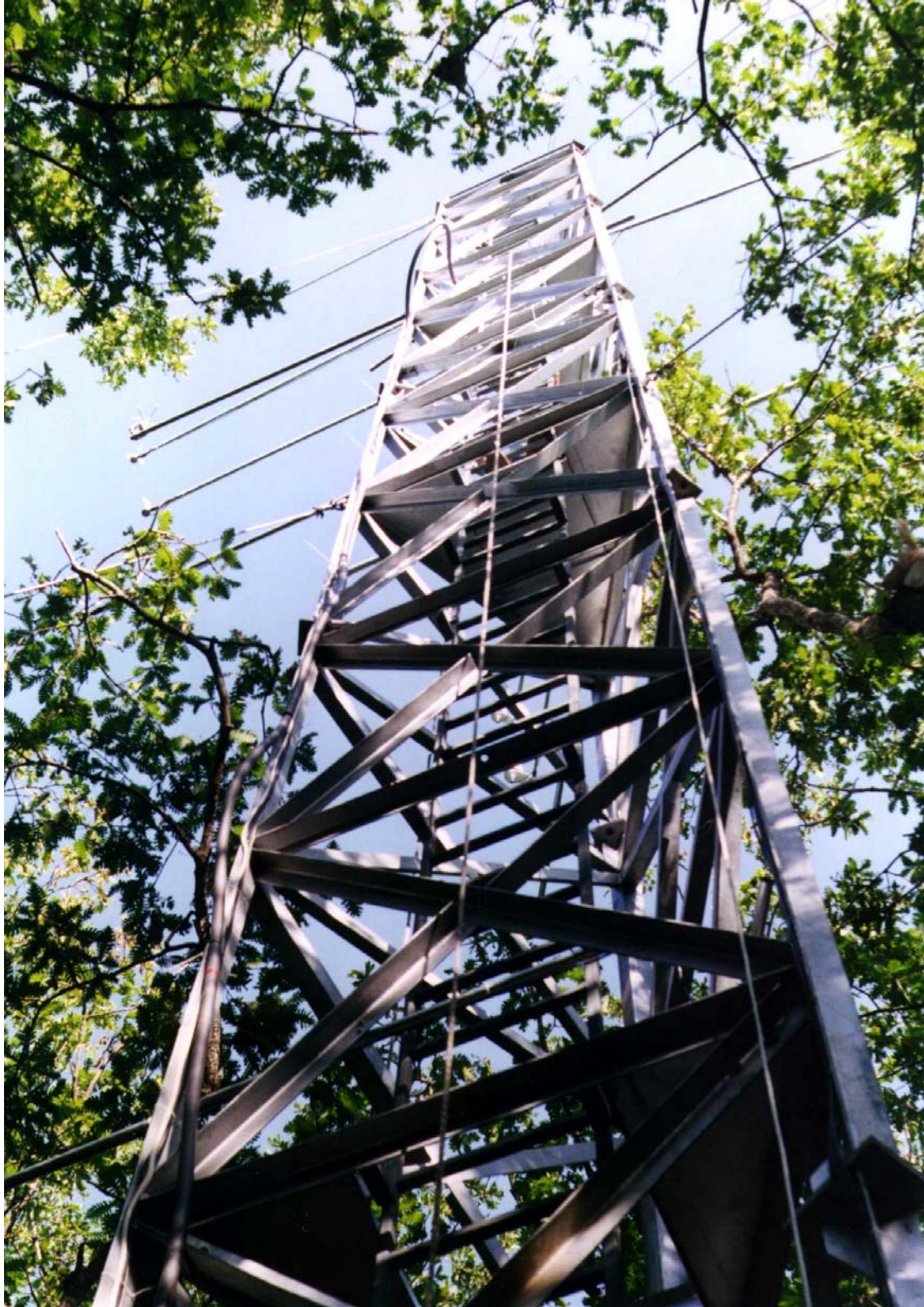
Εικόνα 3.1: Ιστός και αισθητήρες του μικρομετεωρολογικού σταθμού Μογγοστόύ.
