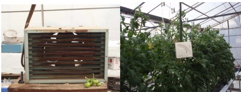
Εικόνα 4-5: Αερόθερμο και θερμοστάτης χώρου
