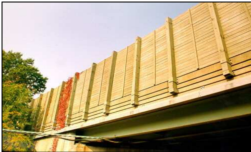
Εικόνα 5.7. Ξύλινο ηχοπέτασμα σε γέφυρα
