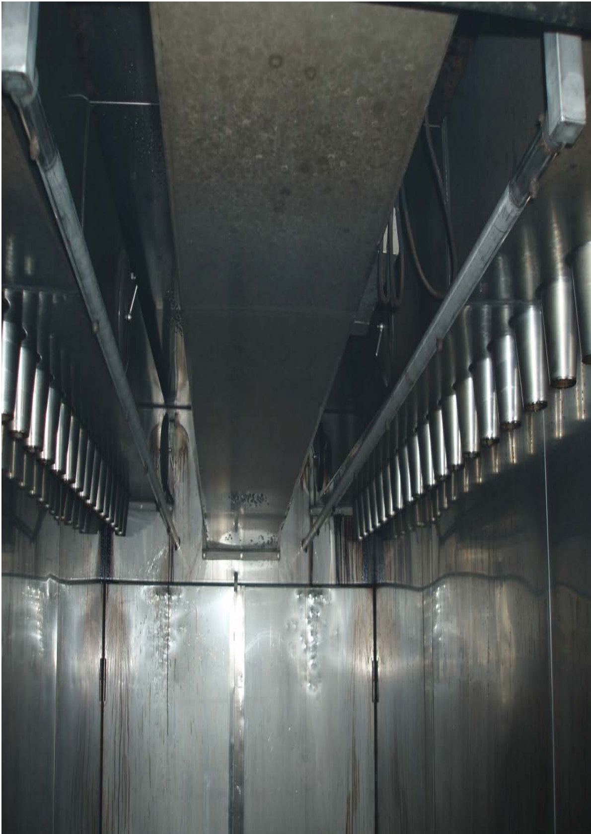
Εικόνα 3. Φωτογραφία των εισόδων και εξόδων αέρα μέσα στο φούρνο
